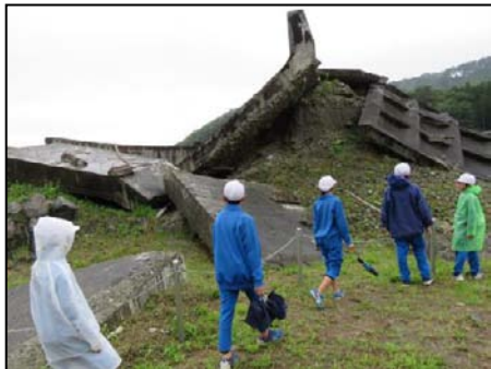
【震災遺構見学：明戸海岸防潮堤】
