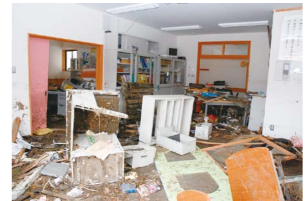
津波の被害を受けた園舎内 (陸前高田市内保育所提供)
