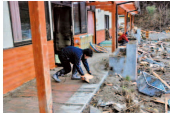
園舎の泥やがれきをかき出す職員 (陸前高田市市内保育所提供)
