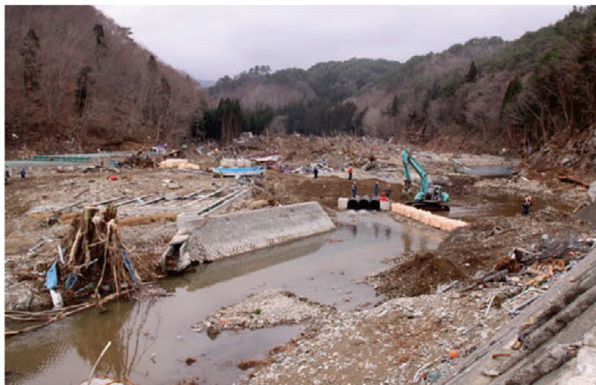
【県道重茂半島線の向渡橋が津波により被災】
