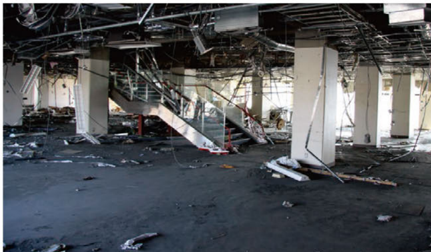
【シートピアなどの館内の被害の状況】
