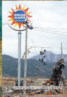
宮古市の被災地。瓦礫の山が広がる中、復興作業が進められている。
