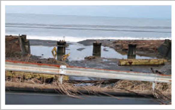
津波により崩落したJR八戸線大浜の鉄橋
