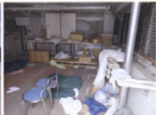
温水発生器室（後日）
