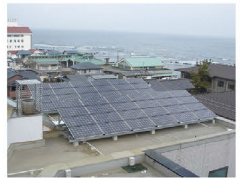
庁舎屋上に設置した太陽光発電設備(洋野町)
