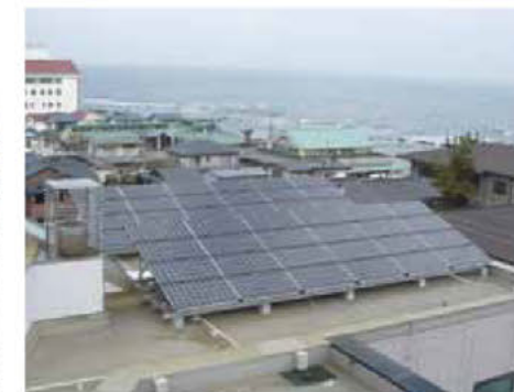
庁舎屋上に設置した太陽光発電設備(洋野町)
