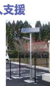
保育所に設置した太陽光発電設備(野田村)
