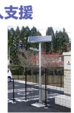
保育所に設置した太陽光発電設備(野田村)
