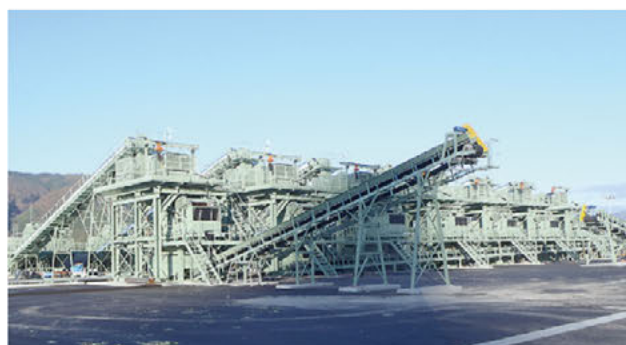
写真3.7.2 除塩施設 1,900 t/日
