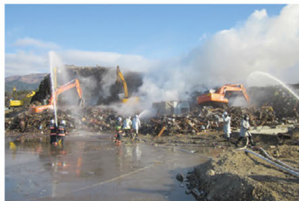
写真 3.4.7 仮置場の火災状況（陸前高田市）
