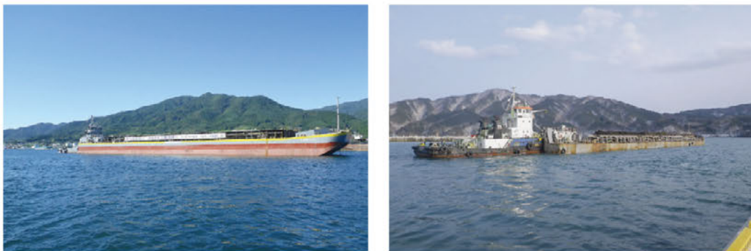
写真 3.6.3 宮古地区、山田地区、大槌地区の海上運搬で使用した 2 船団（3,000 \text{m}^3 積級の土運船と押船）
