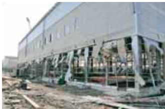
著しく損壊した北日本造船㈱久慈工場
